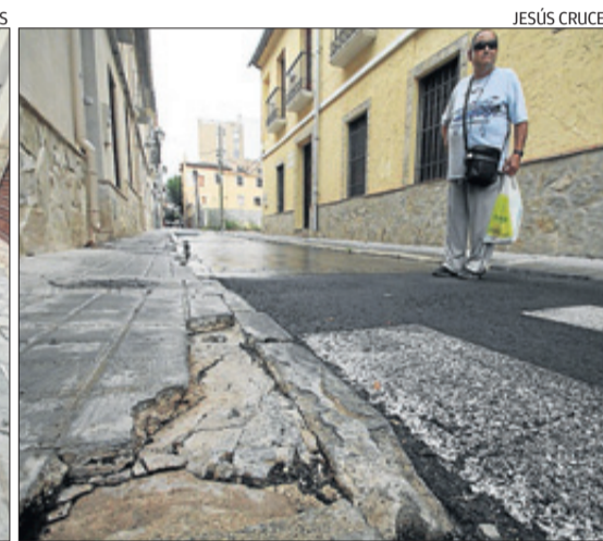
Las aceras no cuentan con rampas para discapacitados. JESÚS CRUCES
