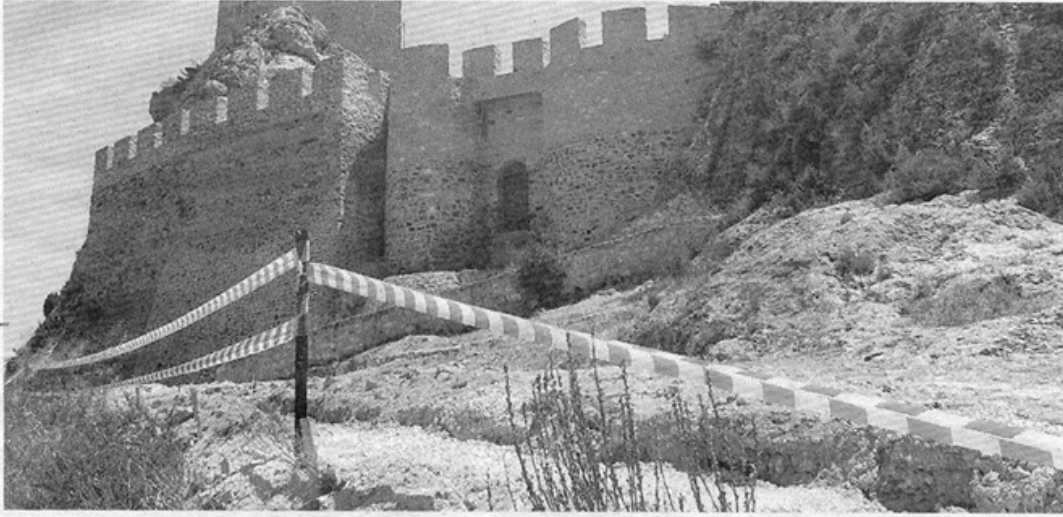
PATRIMONIO. Obras de construcción de la escalinata del castillo de Sax. /R. BERNABEU
